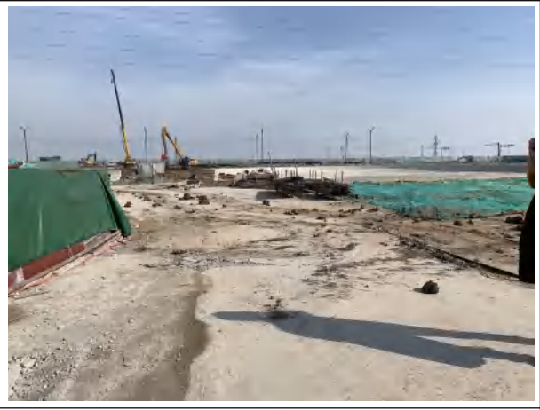
施工便道带泥较多
